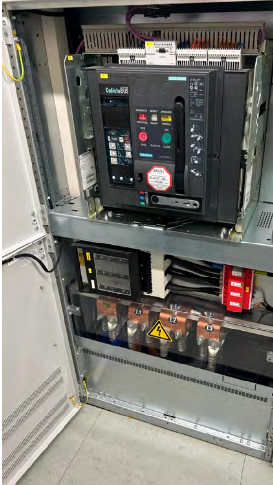
Schaltschranke im Krankenhaus
